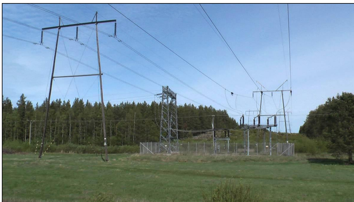
Voimajohto kantatien 88 kohdalla
