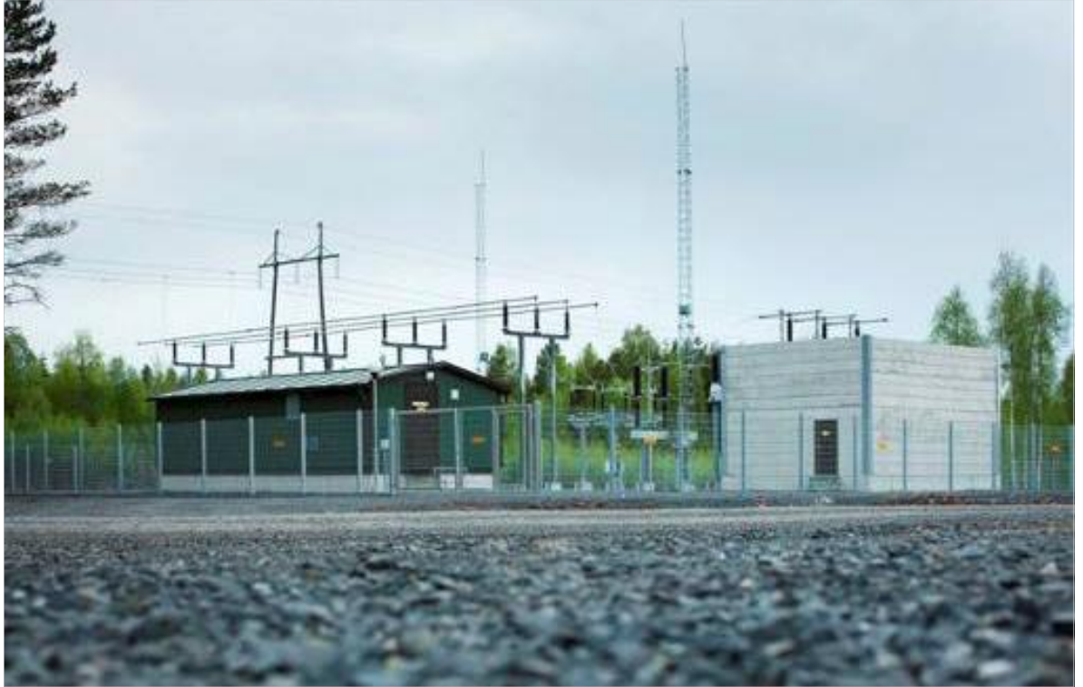
Kuva 22. Näkyvimät komponentit sähköasemalla ovat suojarakennus, kytkinkenttä, ukkosmastot sekä muuntajabunkkeri (kuva VEO OY).
