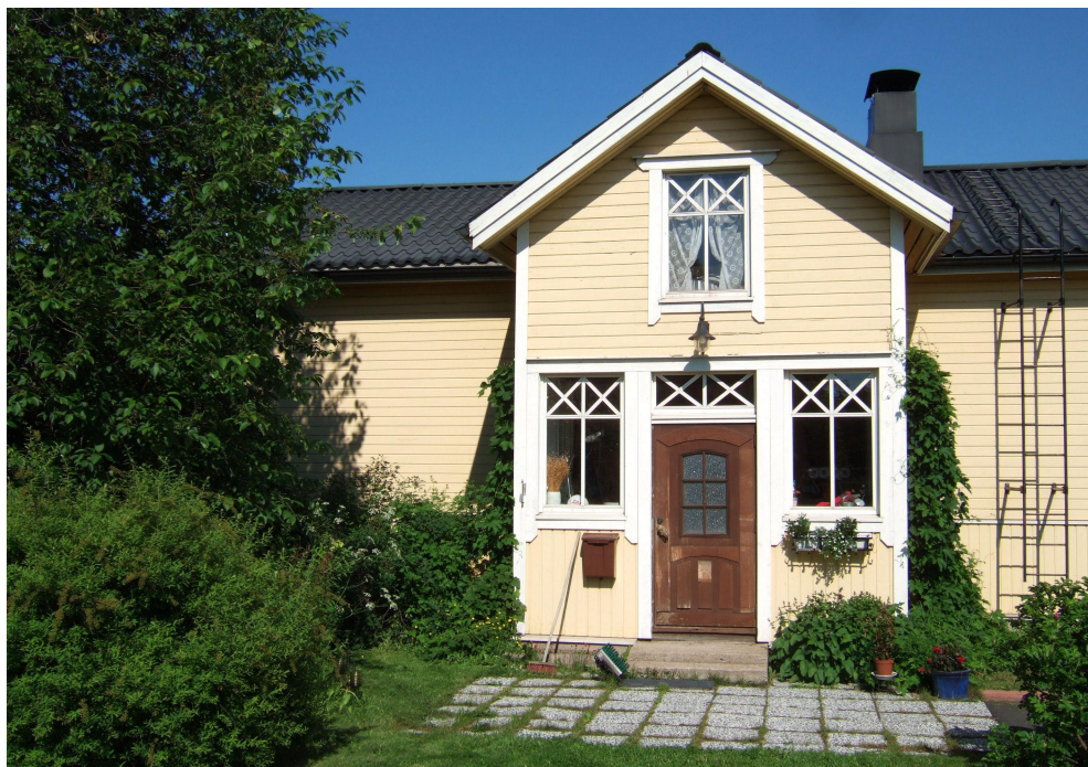
Kuvassa inventointikohde Erkkilän kuisti. Rakennuksen Ikkunat ja julkisivuverhous ovat uudet. Vanhan julkisivun jäsenystä on muutettu vain vähän. Ikkunat ovat vanhan mallin mukaiset, mutta haukkaikkunat on laudoitettu umpeen.
