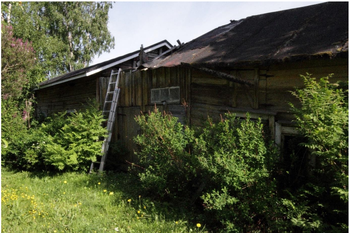
Kuva 7. Tontin eteläreunalla oleva talousrakennus. Kuvan vasemmassa reunassa näkyy entinen navetta ja oikeassa reunassa liiteri. Niiden välissä on entinen lantala, jonka katto on romahtanut.
