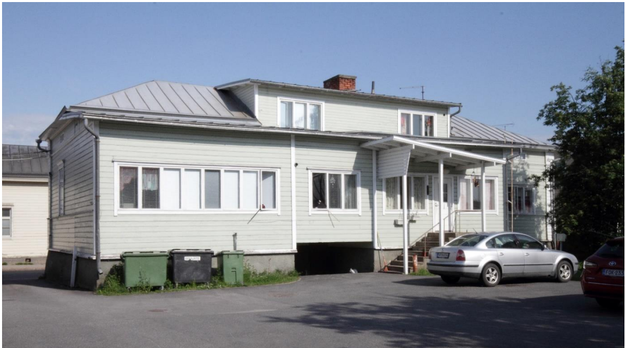
Kuva 3. Kohteen päärakennuksen pihan puoleinen julkisivu. Sitä luonnehtii 1940-luvulla tehty laajennus ja kattolyhty. Rakennuksen ulkonäköä on kuvailtu edellä luvussa "Rakennuksen kuvaus".
