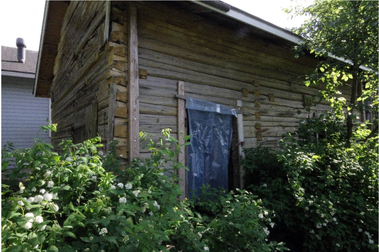
Kuva 8. Tontin eteläreunalla olevan talousrakennuksen itäpäädyssä on entinen navetta. Navetta on kengitetty 2000-luvulla ja hirsirakennetta tuettu följareilla. Rakennuksen päädystä näkyy, että siihen on aiemmin liittynyt muita talousrakennuksia, jotka on purettu.
