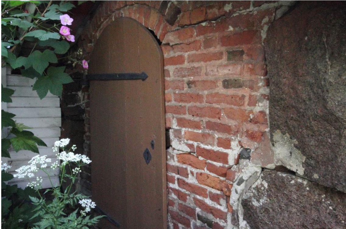
Kuva 6. Kellarin sisäänkäynti. Kellari on rakennettu osittain lohkokivistä ja osittain tiilimuurattu. Oven ympäristö on tiilirakenteinen ja oviaukko on holvimuurattu. Lautaovi on maalattu ruskeaksi.
