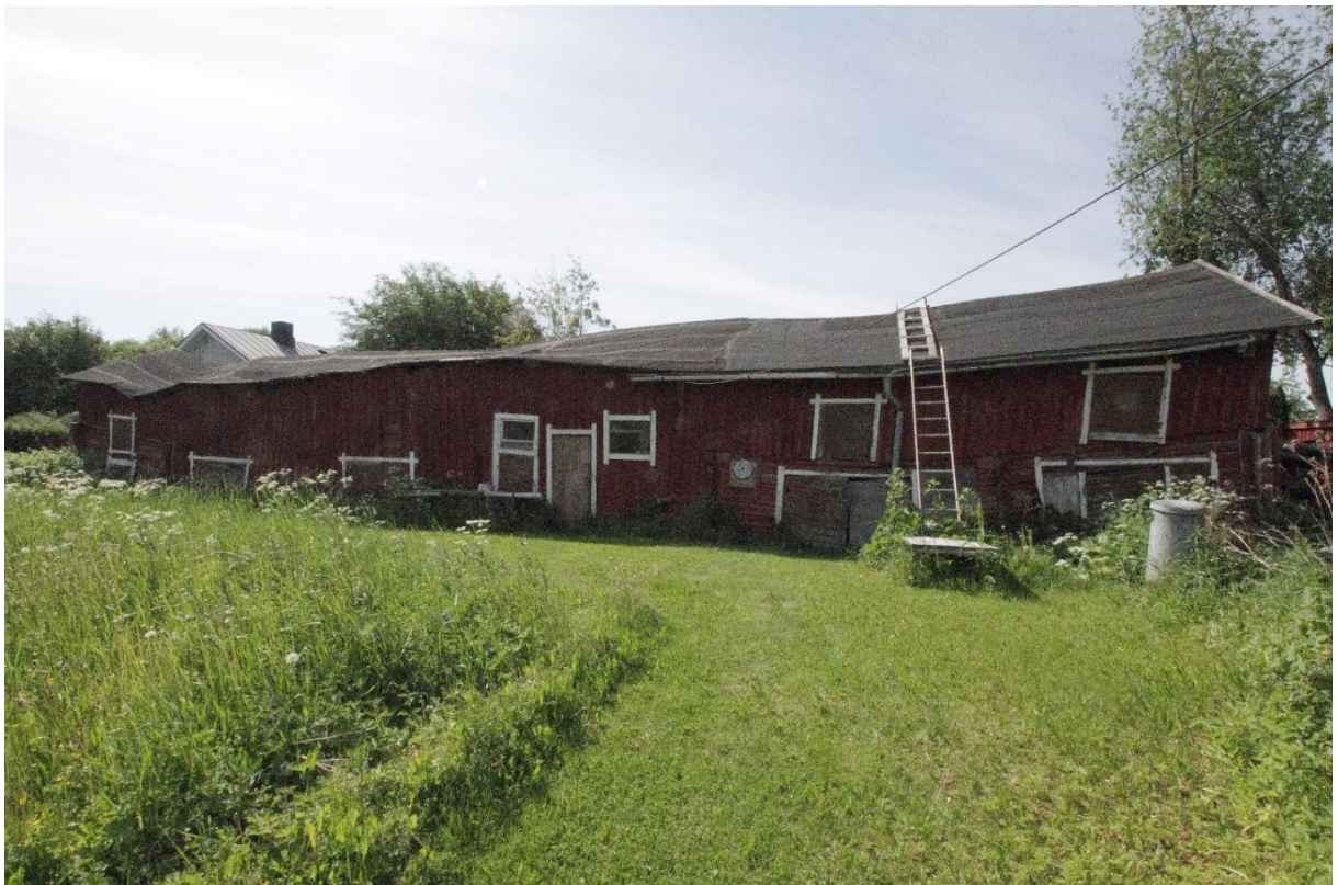
Kuva 9. Kohteen pihan perällä oleva pitkä talousrakennus. Rakennus koostuu yhteen rakennetuista aitoista ja eläinsuojista. Rakennuksen katto on pahoin notkolla eteläpäässä. Rakennuksen ulkonäköä on kuvailtu edellä luvussa "Rakennuksen kuvaus".
