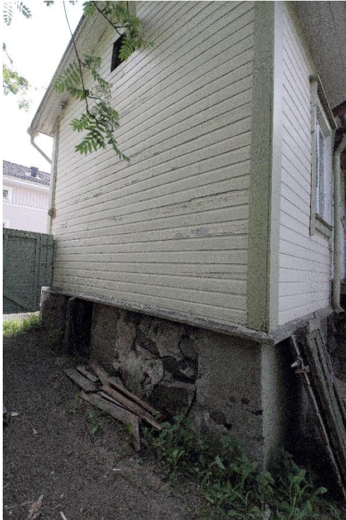
Kuva 4 Vanhan asuinrakennuksen itäpääty. Kivijalka on melko korkea ja tehty osittain luonnonkivistä, osittain betonista. Rakennuksen päädyssä näkyy portti Saaristokadulle.
