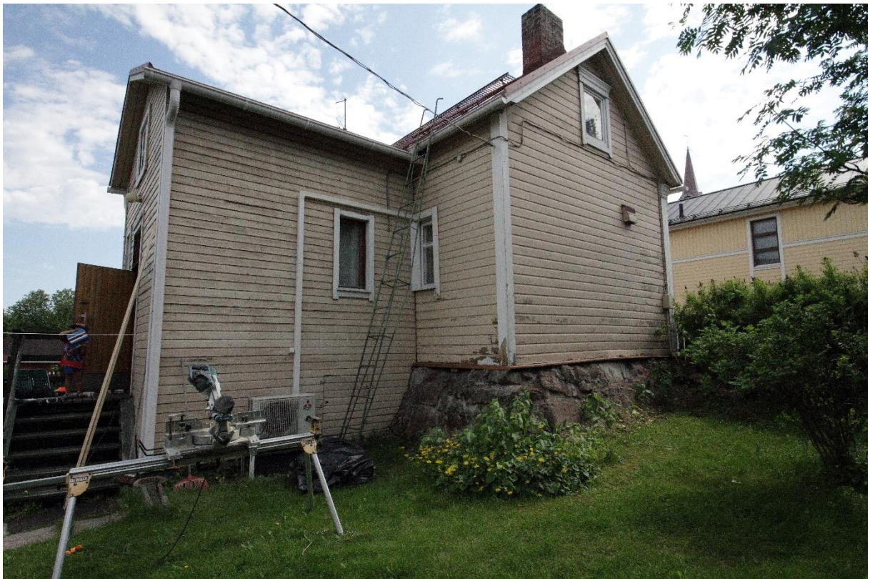
Kuva 3 Päärakennuksessa on pihan puolella umpikuisti, jonne on rakennettu 1970-80-lukujen taitteessa pesutilat. Rinteessä olevan talon kivijalka on pihan puolelta korkea ja tehty osittain luonnonkivistä. Rakennuksen ulkonäköä on kuvailtu edellä luvussa "Rakennuksen kuvaus".
