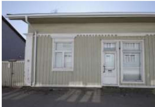
Kuva 72. Kirkkokadun varrella taloihin on avattu 1900-luvulla liiketiloja, jotka nykyisin ovat tyhjiin. Kuvan talossa T-ikkuna on korvattu hieman isommalla pystyikkunalla ja sen vieressä on liiketilän ovi. Muuten rakennus on säilyttänyt hyvin Raahelle tyypillisen ulkuvuorauksen.
